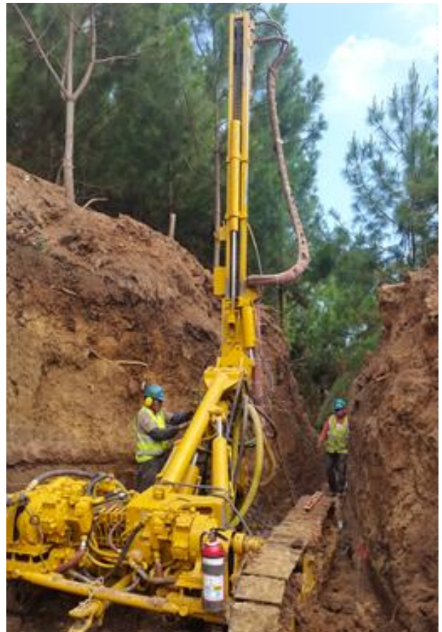
ROPECON CEMENTOS PROGRESO, SAN JUAN SACATEPEQUEZ, GUATEMALA
