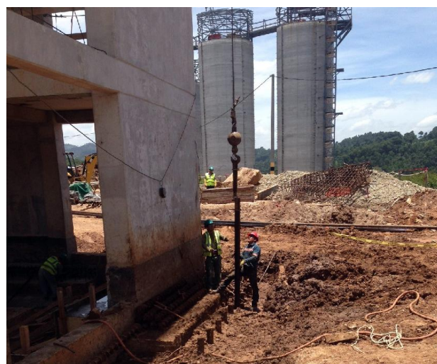
SUB ESTACIÓN EB1-BG10 CEMENTOS PROGRESO, SAN JUAN SACATEPEQUEZ, GUATEMALA
